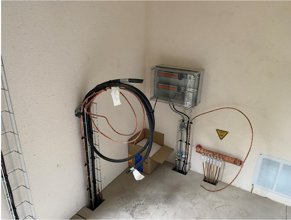
Emplacement tableau de comptage, barre de connexion de terre, bornier de connexions télécommandes
